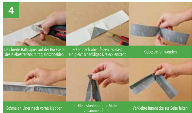
Zur Ausbildung der Ecken werden die Klebestreifen in doppelter Breite des Dämmkeils abgelängt. Anschließend folgen die oben beschriebenen Schritte.
