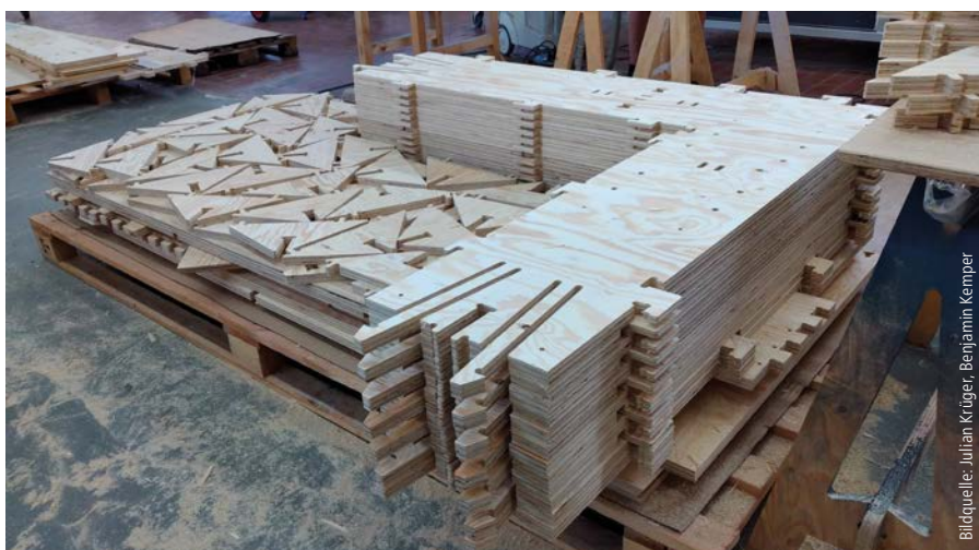
Die handlichen Elemente aus 24 mm starkem Furnierschichtholz wurden von einer CNC-Fräse mit einer Toleranz von nur 0,5 mm zugeschnitten.
